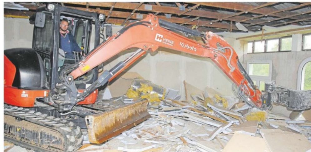
Der Bagger riss Leichtbauwände aus dem ehemaligen Stallgebäude. Hier soll das Hundehaus entstehen.
